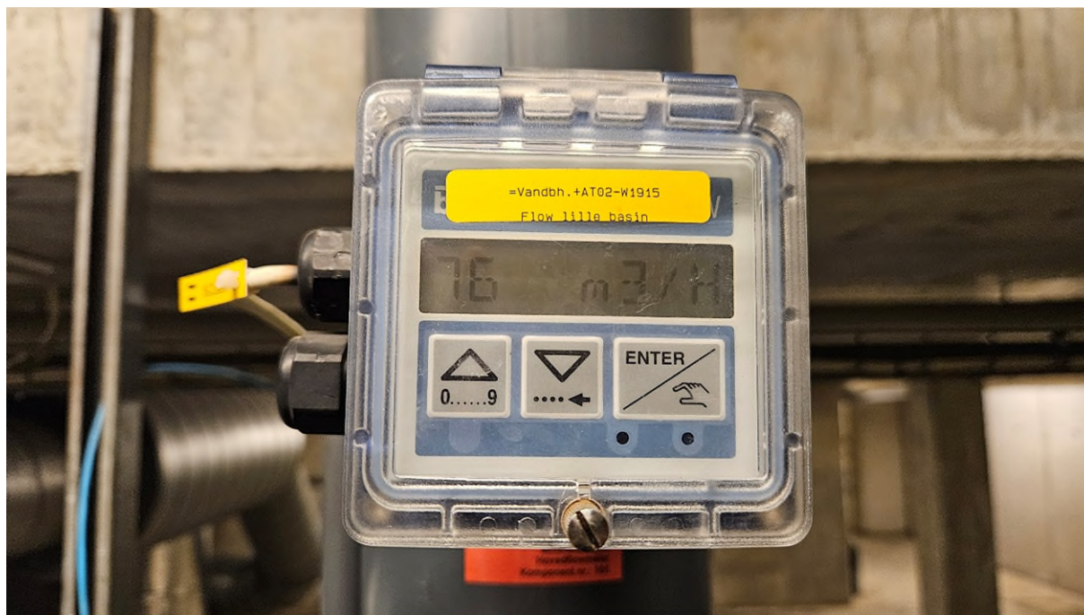
Flowmeter i vandbehandlingsanlægget til Varmtvandsbassinet.
