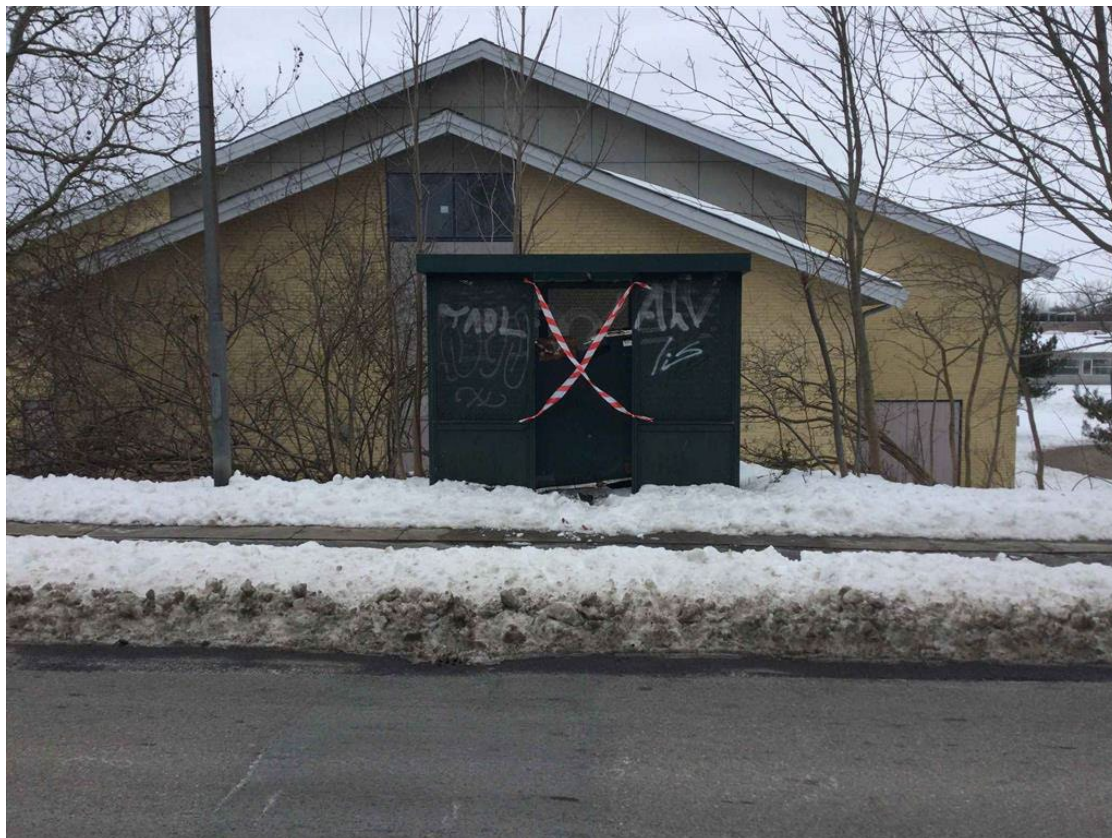
Eksempel 1 - Busskur som er afspærret fordi taget er faldet ned:
