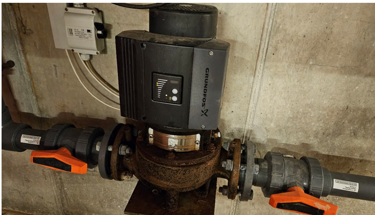
Delstrømpumpe til kulfiltrene.
