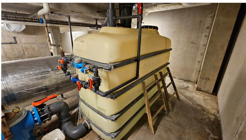
Udligningsbeholder til varmtvandsbassinet.
