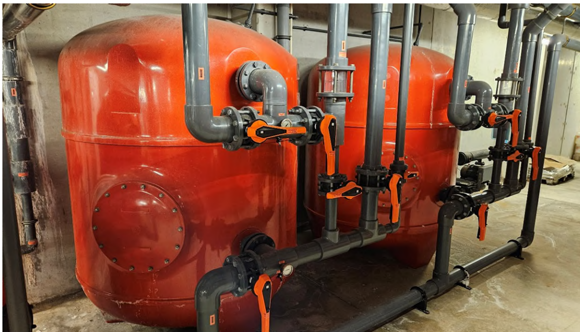
Trykfiltre for varmtvandsbassinet.
