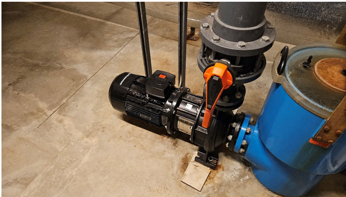
Hovedcirkulationspumpen til Varmtvandsbassinet.
