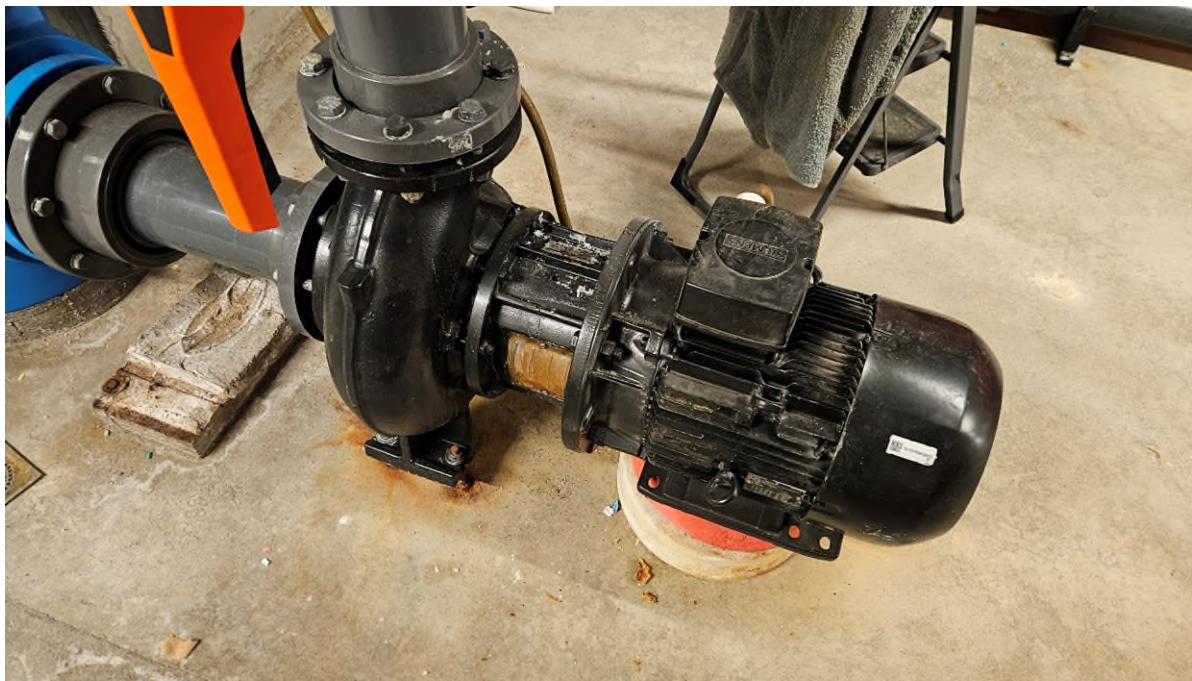
Hovedcirkulationspumpen til Multibassinet.
