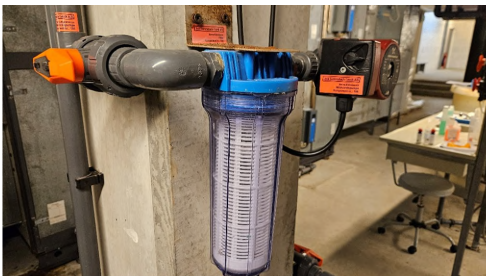
Fødepumpe og forfilter til målevandsautomatikken til Varmtvandsbassinet.
