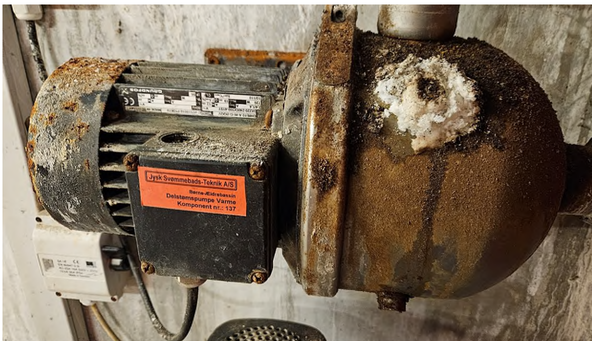
Delstrømpumpe til varmeveksleren.
