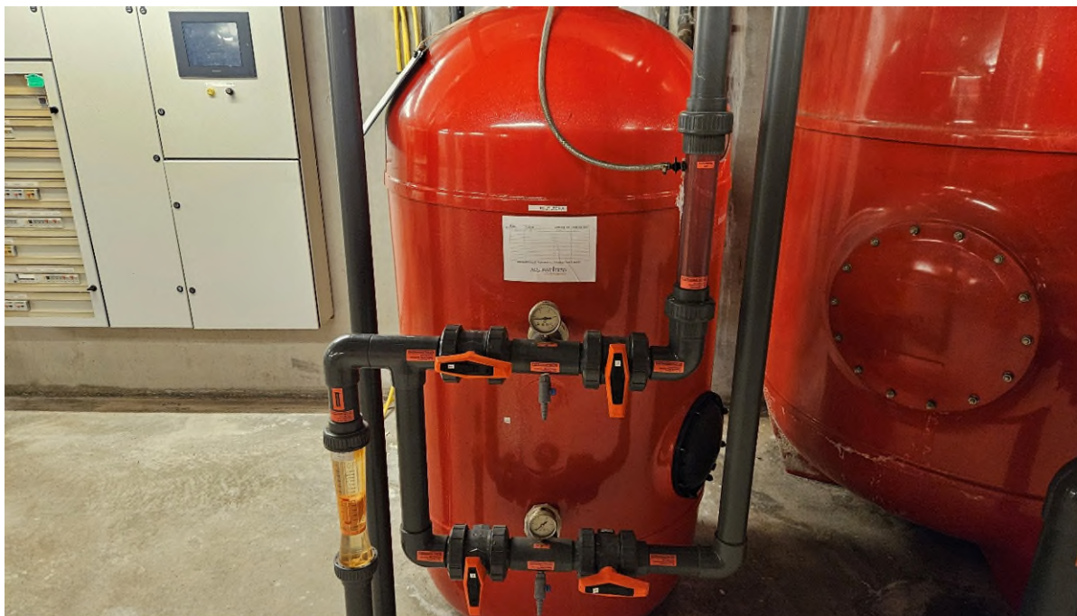
Kulfiltret til Varmtvandsbassinet.
