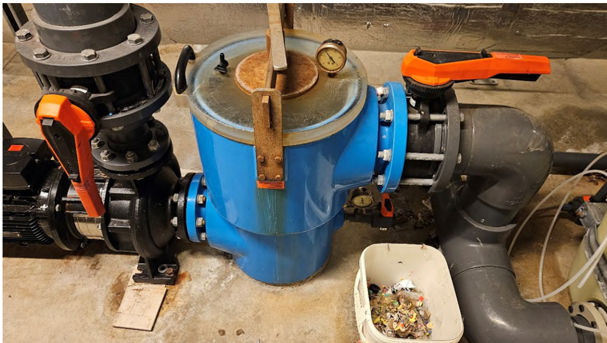
Grovfilter til Varmtvandsbassinet.
