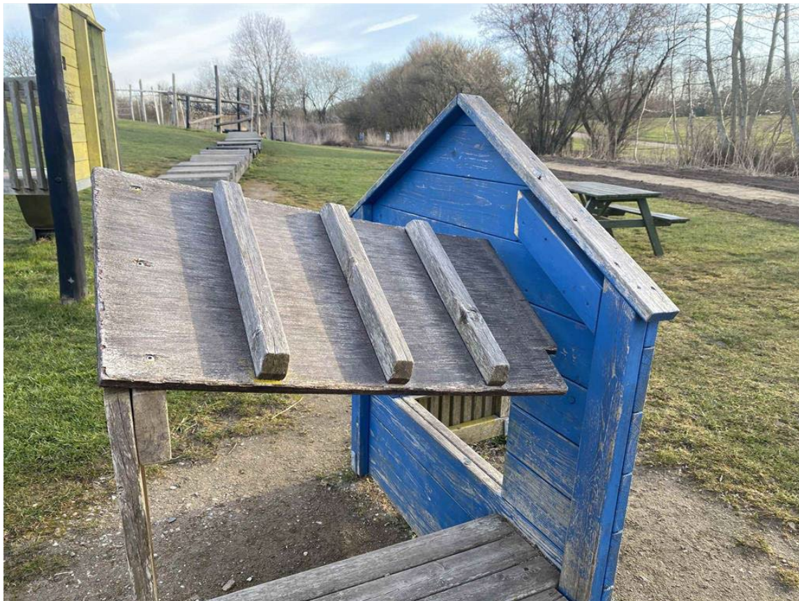
Eksempel 2 - Legehus ved legeplads trænger til reparation og vedligeholdelse.
