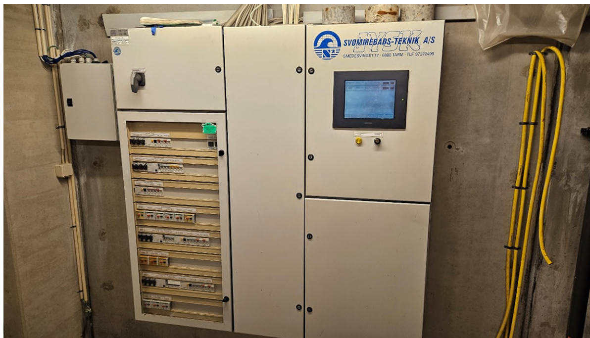
Fælles styretavle til Multi- og Varmtvandsbassinet.
