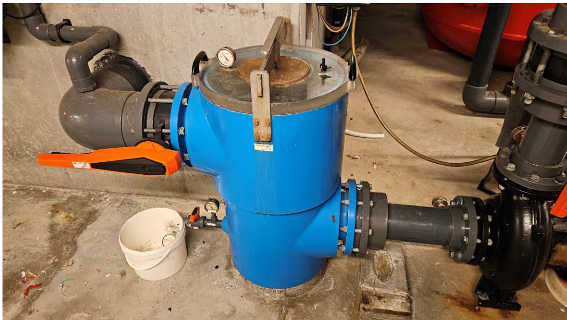
Grovfilter før hovedcirkulationspumpen til Multibassinet.
