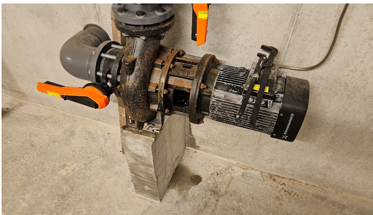
Fælles returskyllepumpe for bassiners filteranlæg.
